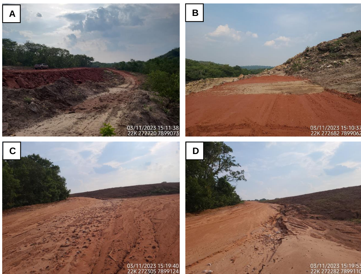
Figura 6.4-1: A, B, C e D): representam a A4 (Casa de Força e Acesso), ainda em fase de instalação. C: Erosão por Sulcos. D: Erosão de Ravinamento. PCH Fundãozinho, Paraíso das Águas, Mato Grosso do Sul. Novembro de 2023.
