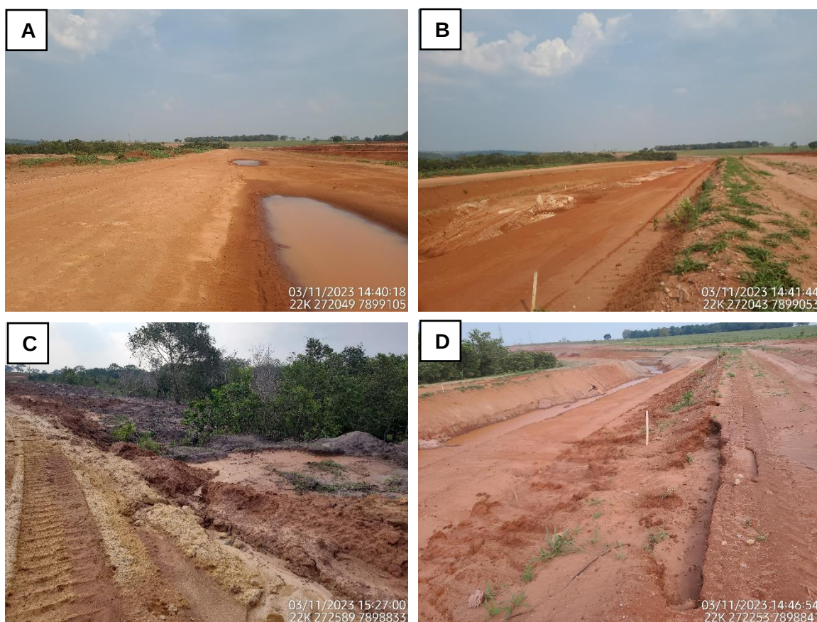
Figura 6.6-1: A, B, C e D: representam a A5 (Canal de Adução e 2º Bota-Fora), ainda em fase de instalação. C e D: Erosão por Sulcos. PCH Fundãozinho, Paraíso das Águas, Mato Grosso do Sul. Novembro de 2023.
