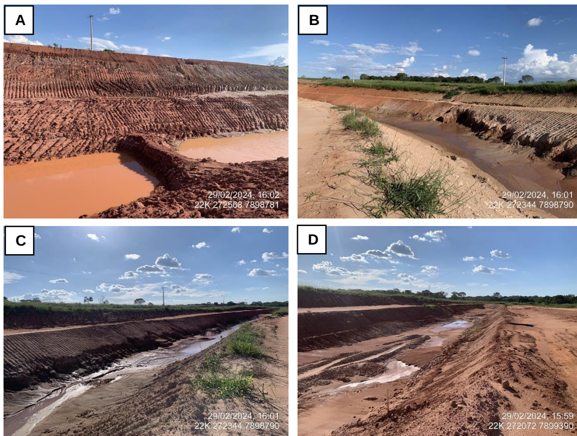
Figura 6.6-2: A, B, C e D: representam a A5 (Canal de Adução e 2º Bota-Fora), ainda em fase de instalação. A, B, C e D: Erosão por Sulcos. PCH Fundãozinho, Paraíso das Águas, Mato Grosso do Sul. Fevereiro de 2023.
