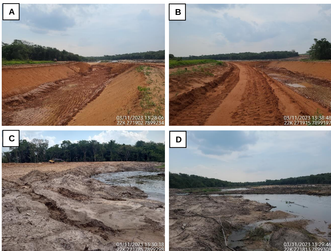
Figura 6.1-1: A e B: representam a A1 (Entorno do Reservatório e Barramento) início do Canal de Adução, ainda em fase de instalação. C e D: também representa a A1, após a fase de supressão vegetal. (C) Erosão de Ravinamento. PCH Fundãozinho, Paraíso das Águas, Mato Grosso do Sul. Novembro de 2023.
