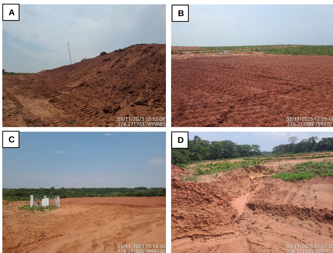
Figura 6.3-1: A, B, C e D: representam a A3 (Futura Casa de Hóspedes), ainda em fase de instalação. PCH Fundãozinho, D: Erosão de Ravinamento. Paraíso das Águas, Mato Grosso do Sul. Novembro de 2023.
