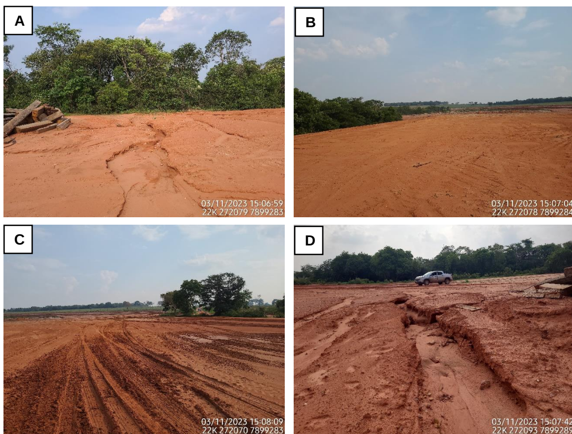
Figura 6.5-1: A, B, C e D: representam a A5 (Canteiro Industrial), ainda em fase de instalação. A e D: Erosão por Ravinamento. C: Movimentação de Solo relacionada a Passagem de Maquinário. PCH Fundãozinho, Paraíso das Águas, Mato Grosso do Sul. Novembro de 2023.
